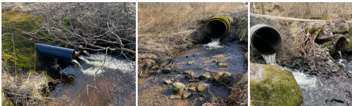
Tre vägtrummor som är vandringshinder för fiskar, nerifrån och upp.
